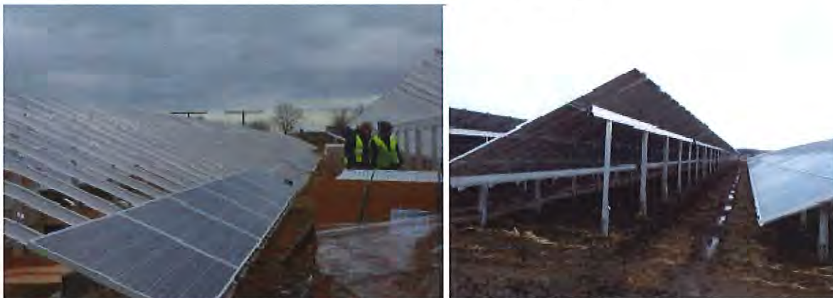
Abbildung 5: Beispiel für eine Photovoltaik-Freiflächenanlage desselben Vorhabenträgers aus Nordholz (Landkreis Cuxhaven, Niedersachsen).
